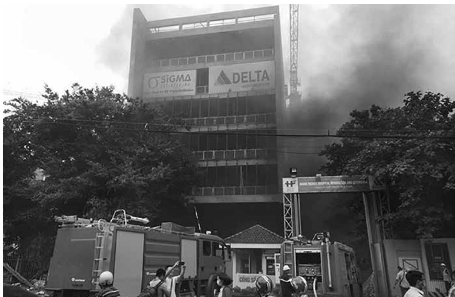
Vụ cháy tại công trường xây dựng Bệnh viện Việt Pháp, địa chỉ số 1, phường Phương Mai, quận Đống Đa, thành phố Hà Nội
